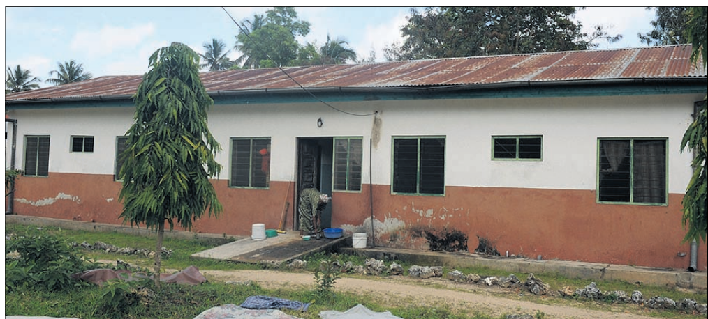
Bedarf dringend der Renovierung: ein weiteres Frauenhaus auf dem Altenhügel „Welezo“ auf Sansibar.
